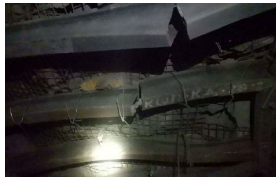
Рис. 8 – Локальна деформація конвеєрного штреку на етапі підтримання в зоні опорного тиску перед очисним вибоєм.
