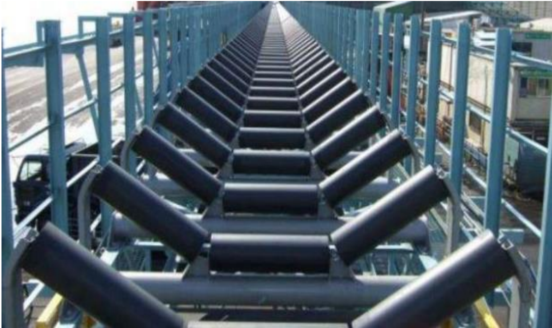
Рис. 1.13. Загальний вигляд конвеєрного ставу зі знятою стрічкою
