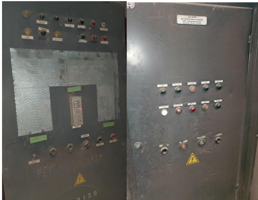
Рисунок 1.2 – Щит КВПтаА сушильного барабану №2
