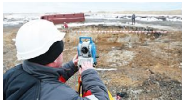
Рис. 6. Котлован оголовка та елементи опускного «ножа» на проммайданчику блоку №12 ШУ «Покровське», с. Зелене, 2021 рік
