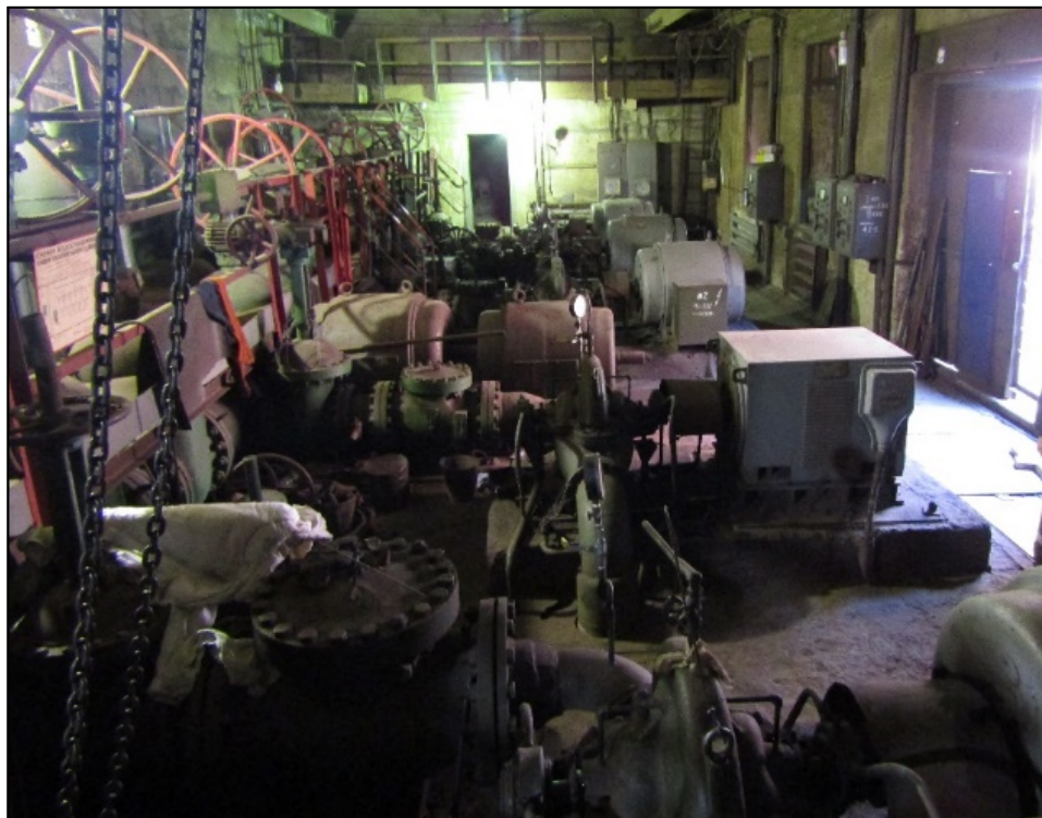
Рисунок 1.2 – Насосна станція системи водопостачання мартенівського виробництва
