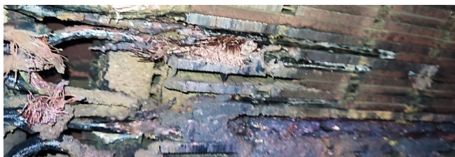
Рис. 2. Фрагмент пошкодження статорної обмотки та наявні очаги оголення окремих витків обмотки, що очевидно і призвело до пробою та поширення електротермічного процесу в генераторі
