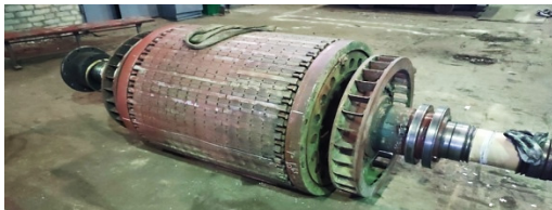
Рис. 4. Зовнішній вигляд ротора пошкодженого високочастотного однофазного генератора. Зовні видно поверхневі пошкодження та наслідки деяких механічних та електричних пробоїв ізоляції
