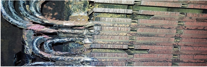
Рис. 3. Наслідки дії сукупності перевищень навантаження, електротермічного процесу, електродинамічних зусиль в лобовій частині статорної обмотки генератора (зліва видно розвиток короткого замикання в місцях оголення ізоляції, біля 20 оголень ізоляції (дивись весь фрагмент))
