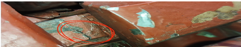
Рис. 5. Фрагмент механічного пошкодження (трищина) в роторі, що є показником багаточисельних електродинамічних процесів внаслідок коротких замикань (Відомо, що короткі замикання призводять до формування і розвитку низки небезпечних електромагнітних процесів внаслідок великих значень полів розсіювання в порожнині устаткування)
