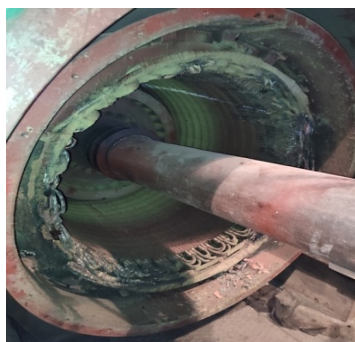
Рис. 1. Загальний вигляд статора із явними пошкодженнями лобової частини внаслідок дії електротермічного та інших процесів
