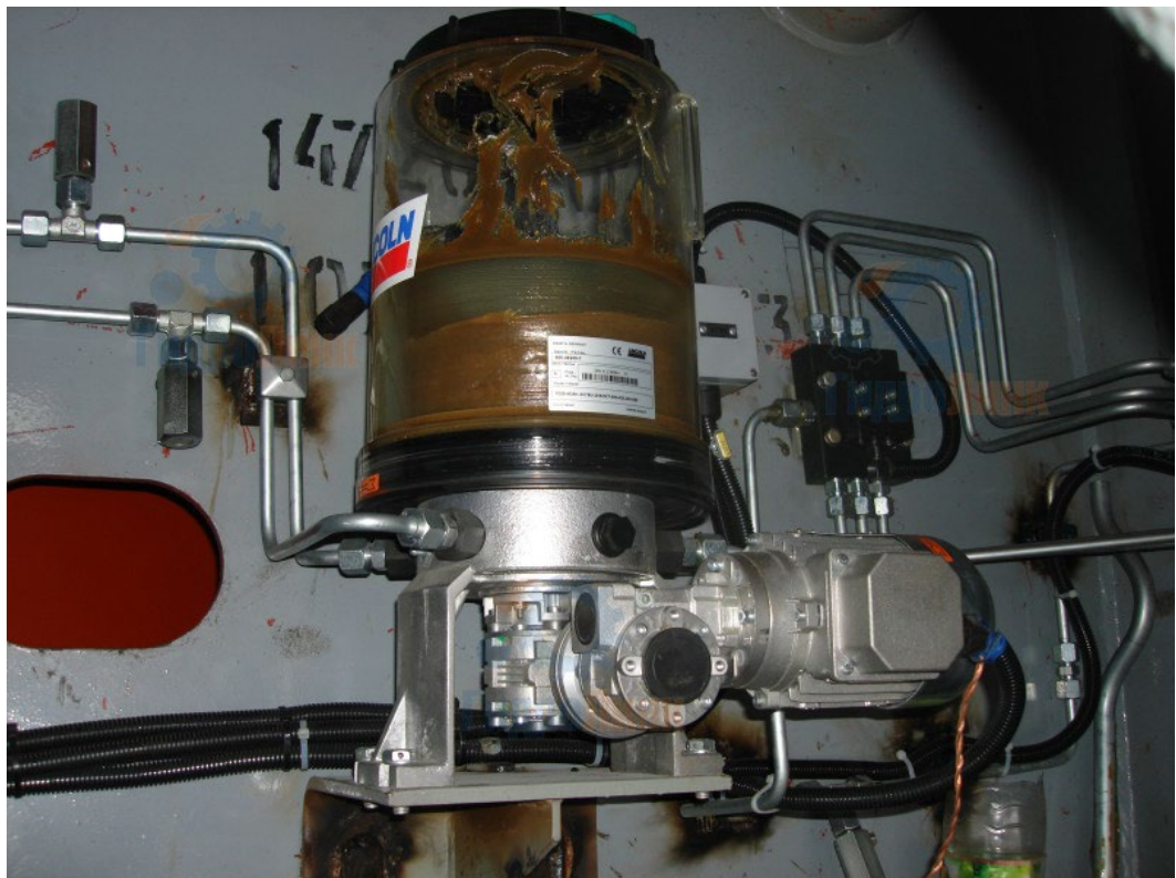
Рисунок 3.2 - Насосна станція АЦСС Lincoln
