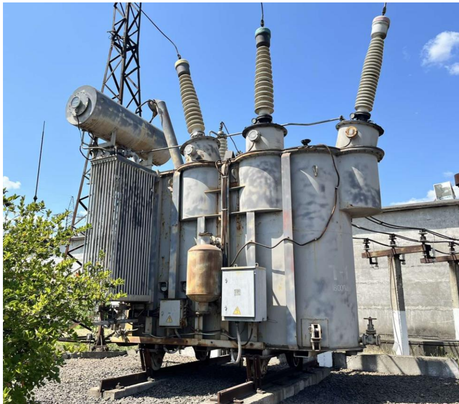
Рисунок 1.1 – Зовнішній вигляд основної електричної машини підстанції – силового трансформатора 150/6 кВ
