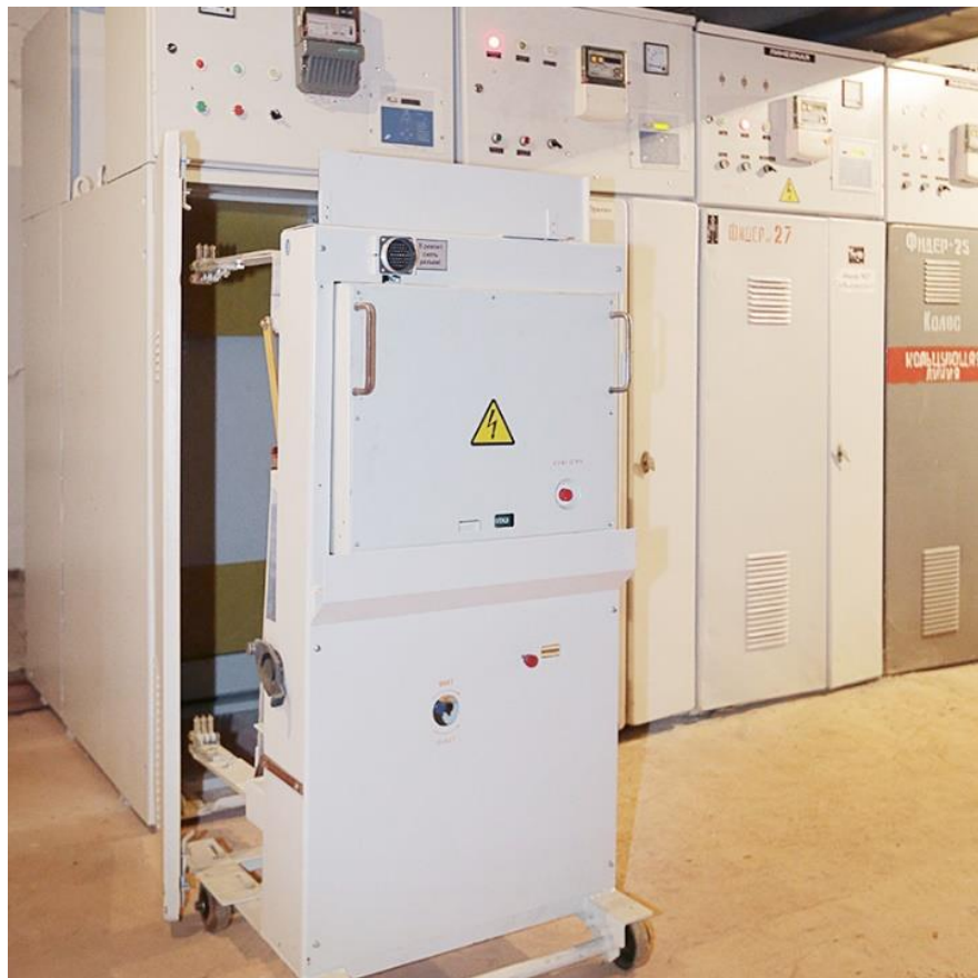
Рисунок 2.1 – Комірка високовольтна КРУ-2-10 з викотним елементом – високовольтним вимикачем в складі діючої електроустановки
