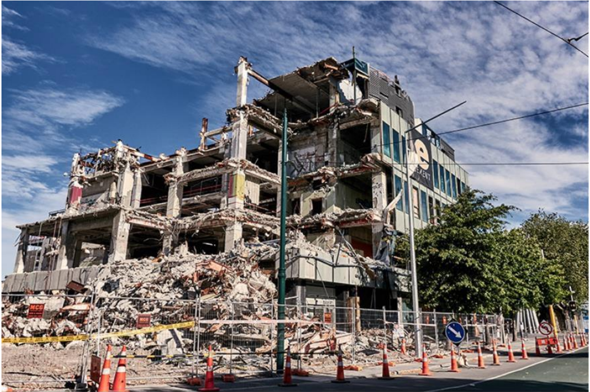
Рисунок 1.5 Зруйнована будівля в м. Крайстчерч
