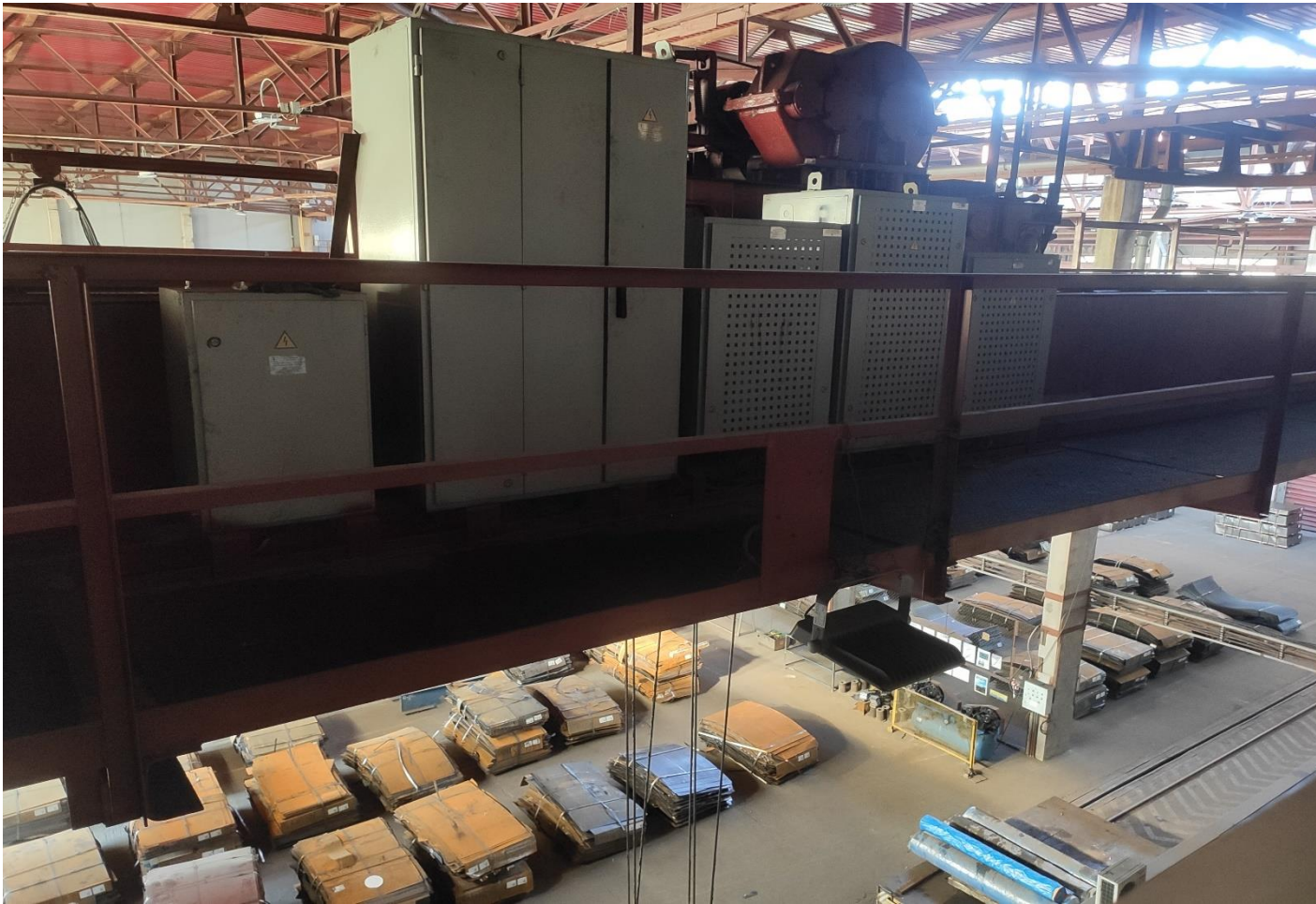
Рисунок В.1 – Вантажний візок та електрообладнання мостового крану КМ-1635
