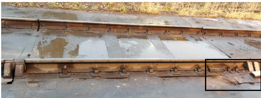
Рисунок – 1.2 Руйнування бетонної основи
