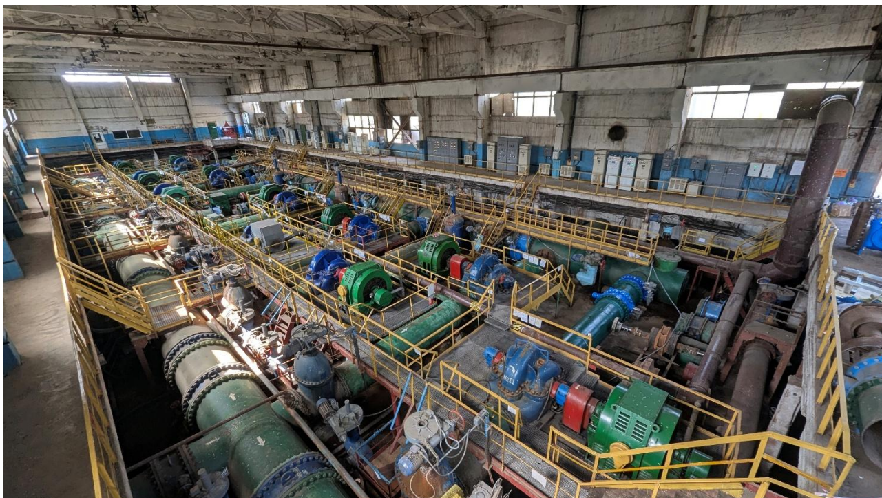
Рисунок 1.2 – Загальний вид обладнання НСЗВ
