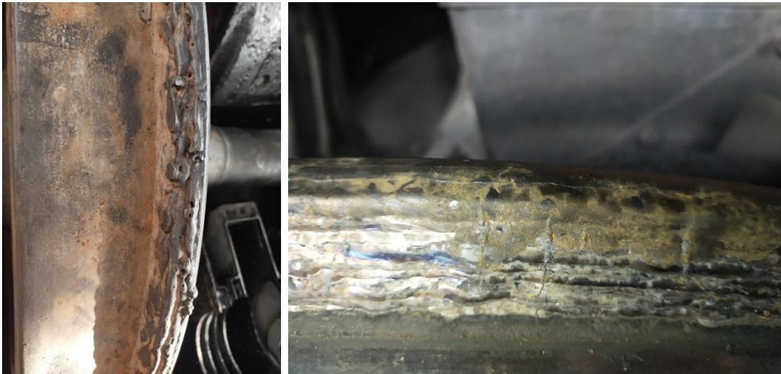
Рисунок 34 - Приклад неякісного зварного шву
