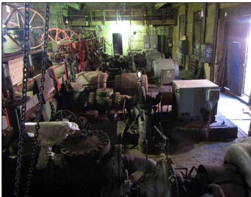
Рисунок 1.2 – Насосна станція мартенівського цеху
