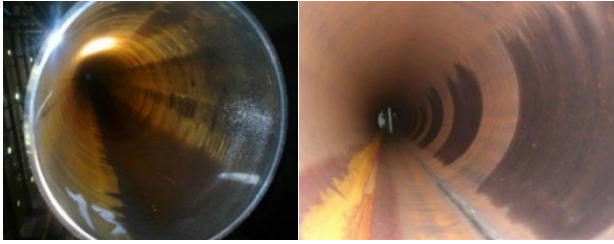
Рис. 2.73. Неприпустимі жирові забруднення поверхні труб
