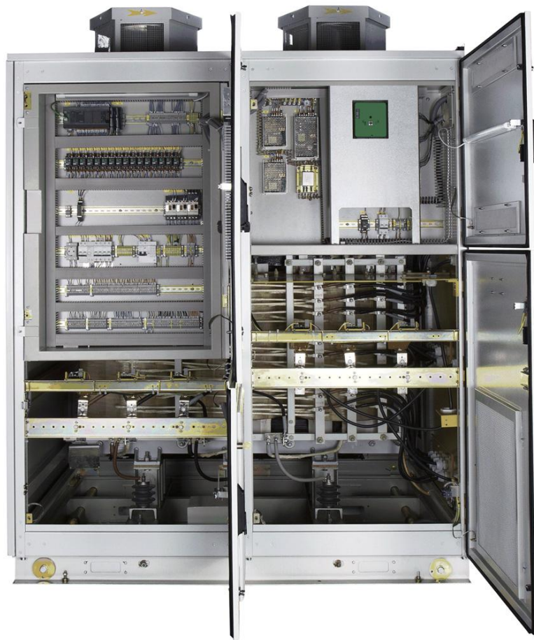
Рисунок 3.5 – Зовнішній вигляд внутрішніх блоків
