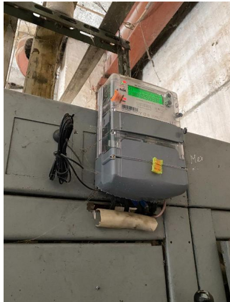
Рисунок 1.7 - Існуюча трансформаторна підстанція ПП «Метал», від якої здійснюється живлення підприємства на напрузі 0,4 кВ
