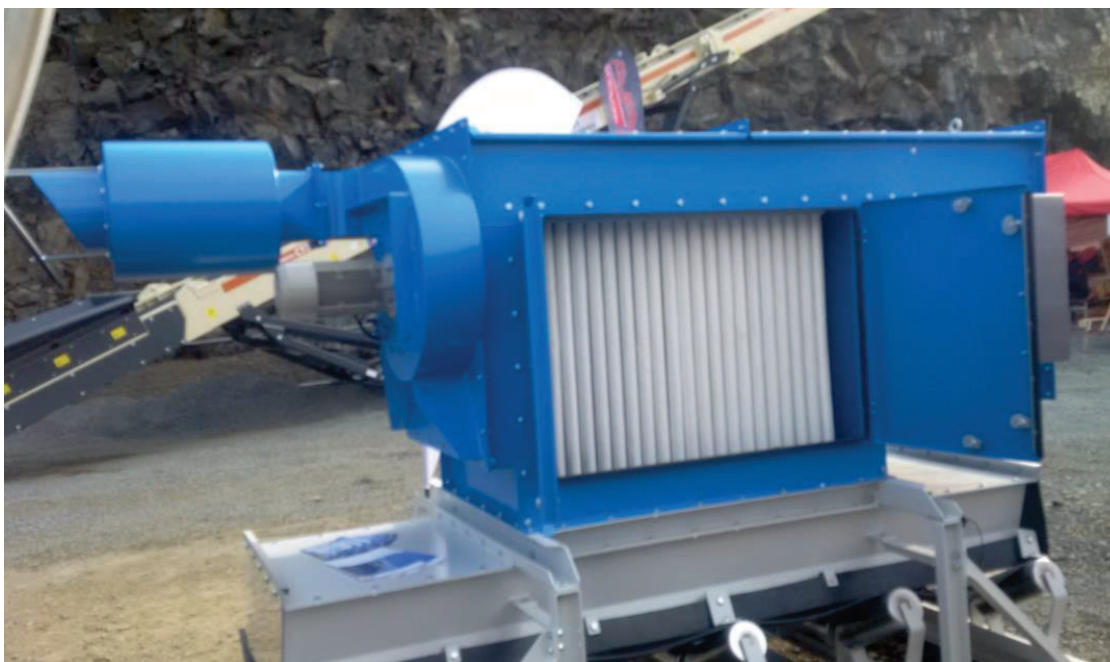
Рисунок 3.1 – Фільтр ВAF, встановлений на стрічці
