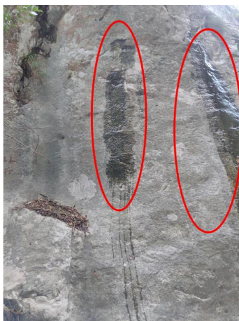
Рисунок 7.13 – Бетонна дамба хвостосховища. Фільтрація води через пори в моноліті («сльози»)
