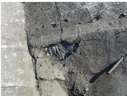
Рисунок 7.16 – Придонна внутрішня частина дамби хвостосховища. Порушення гідроізоляції внаслідок руйнування захисного покриття
