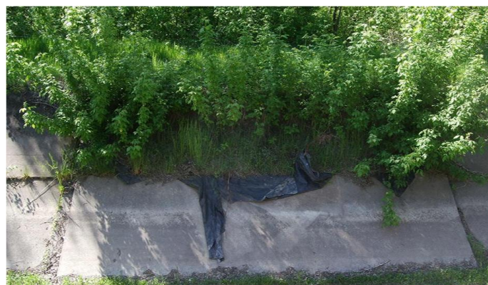
Рисунок 7.17 – Внутрішня частина дамби хвостосховища. Зповзання бетонних плит, оголення і порушення плівкової гідроізоляції
