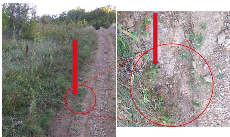
Рисунок 7.15 – Центральна частина зовнішнього схилу дамби хвостосховища. Фільтрація у вигляді слабого замочування ґрунту
