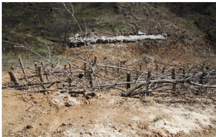
Рисунок 7.9 – Зовнішній схил дамби покинутого хвостосховища. Дерев'яний пальовий ряд вказує на зсув ґрунту, що зійшов
