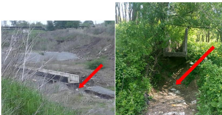
Рисунок 7.7 – Нагірні дренажні канали та лотки. Неправильне відведення вод із території хвостосховища спричинило донну ерозію тальвегу балки/яру. Дренажна система може бути зруйнована при подальшому розвитку ерозії
