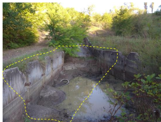
Рисунок 7.21 – Засмічений водоскидний канал хвостосховища
