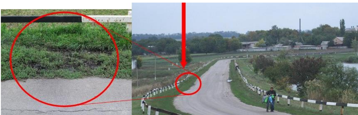
Рисунок 7.4 – Зовнішній схил дамби хвостосховища. Похилений автодорожній відбійник і тріщина відриву в цьому місці – неявні ознаки зсуву ґрунту, що формується
