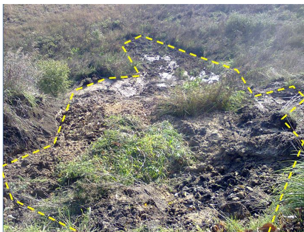
Рисунок 7.8 – Зовнішній схил дамби. Текучий зсув ґрунту (опливіна), що свідчить про її сильне обводнення (Вид із дамби)
