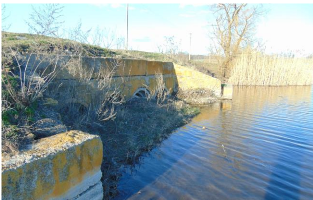
Рисунок 7.20 – Аварійний водоскид хвостосховища із входами, заблокованими наносами
