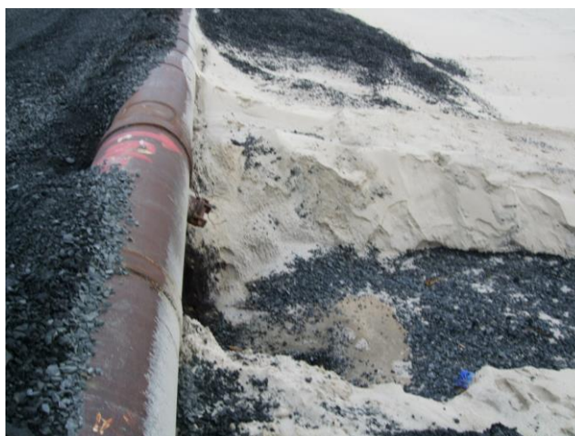
Рисунок 7.6 – Внутрішній укіс дамби хвостосховища. Розмив унаслідок витоків зі шламових труб
