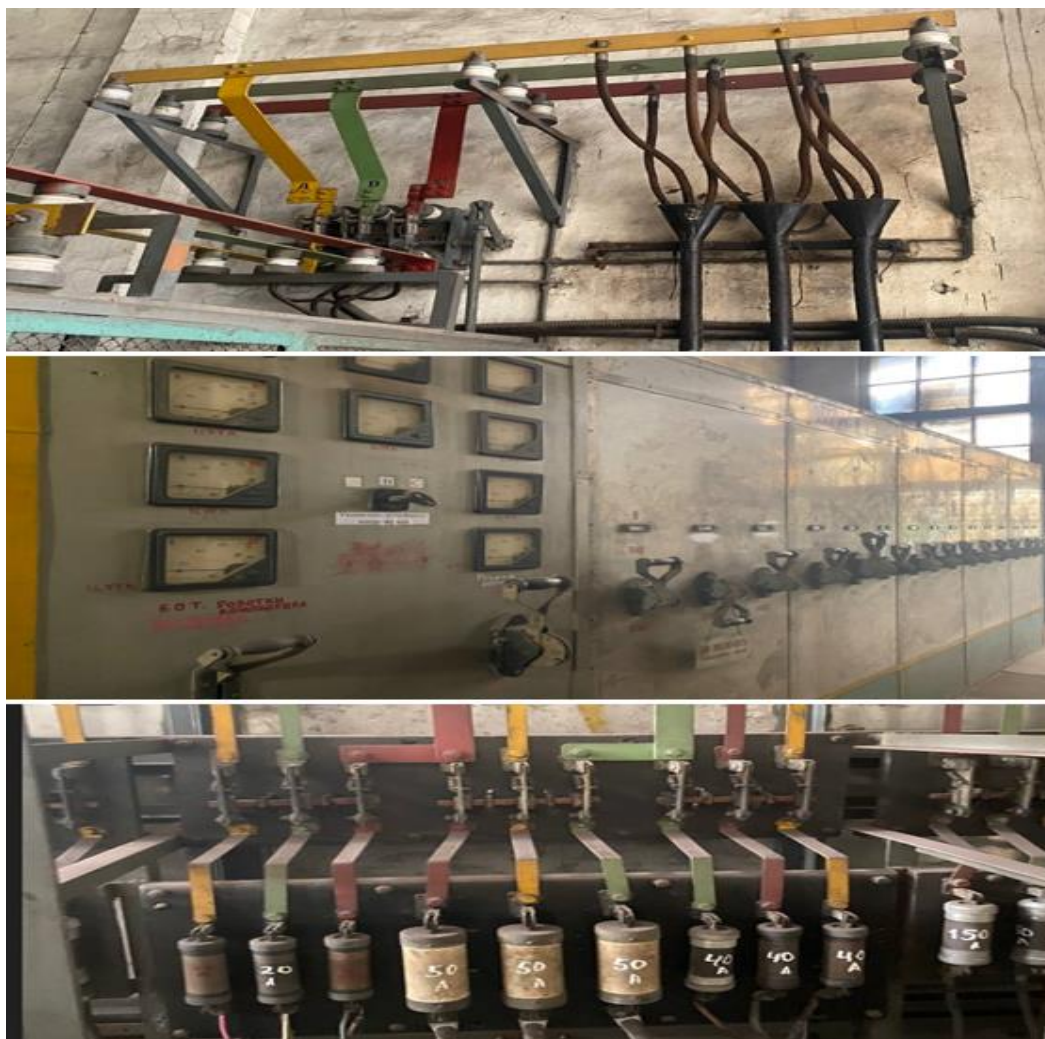
Рисунок 1.3 – Підстанція №41 напругою 6/0,4 кВ.
