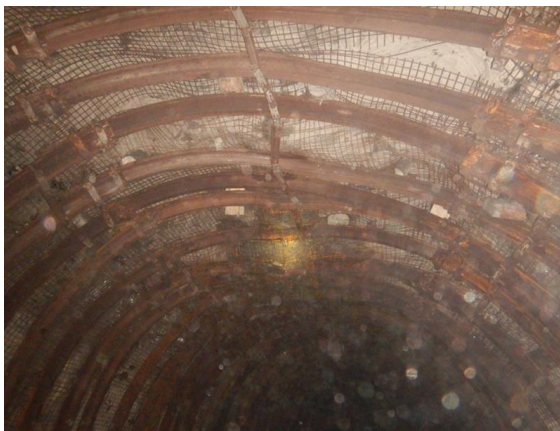
Рис. 22. Деформація рам кріплення на контрольній ділянці
